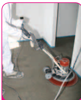
IL MASSETTO VIENE RIFINITO CON MACCHINA ROTANTE CON POCA O SENZA ACQUA IN BASE ALLA TEMPERATURA ESTERNA
